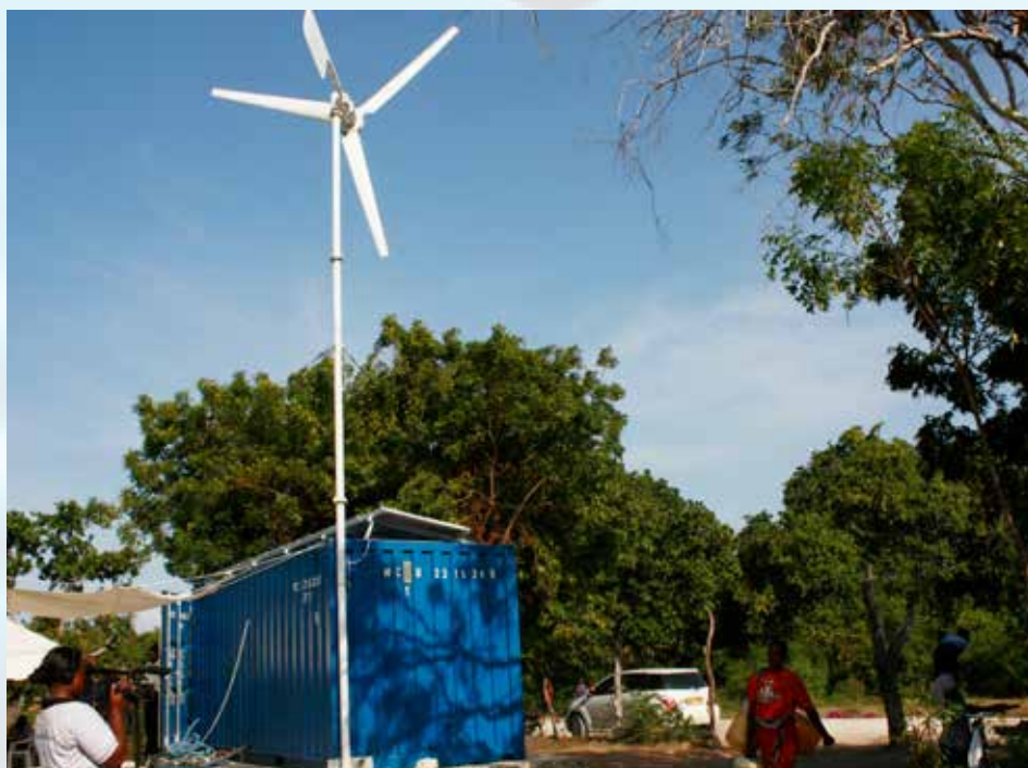
L'usine d'épuration de l'eau soutenue par l'ONUDI utilise l'énergie éolienne et solaire. (Photo: Projet COAST)
