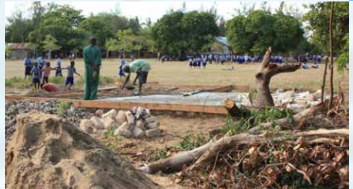
La construction de la plateforme pour la station d'épuration est maintenant terminée. L'installation de l'équipement de l'eau est prévue dès que possible (Photo: Projet COAST)
