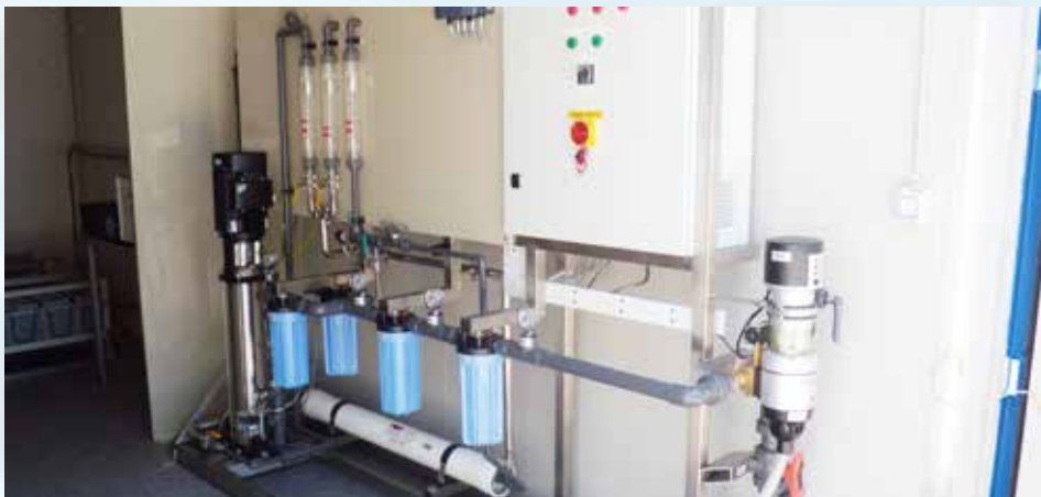
Une photo de l'équipement de traitement des eaux qui utilise la technologie d'osmose inversée (Photo: Projet COAST)
