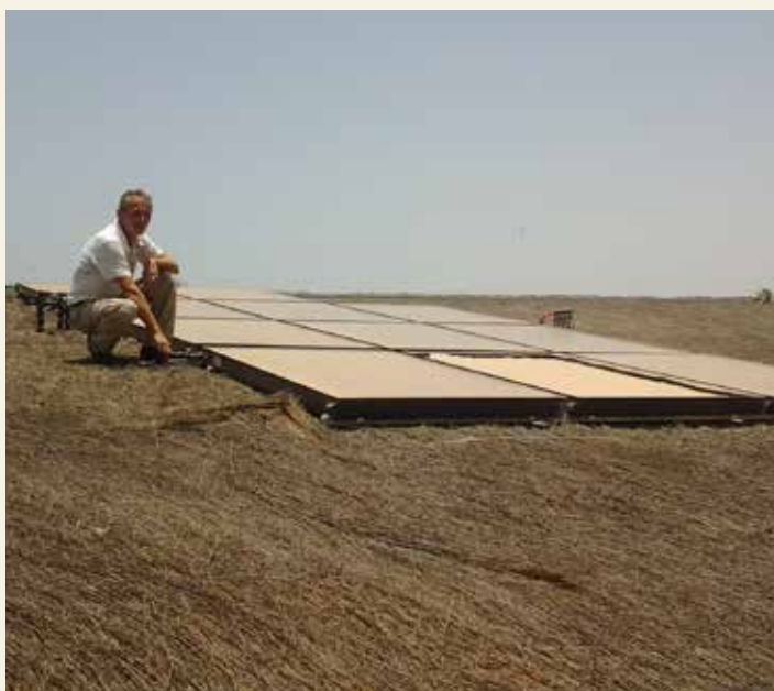
M. Martin Schmitz, personnel technique de l'hôtel Lamantin, avec les panneaux solaires installés dans la toiture de l'hôtel, utilisés pour le chauffage de l'eau de l'établissement (Photo: Projet COAST)
